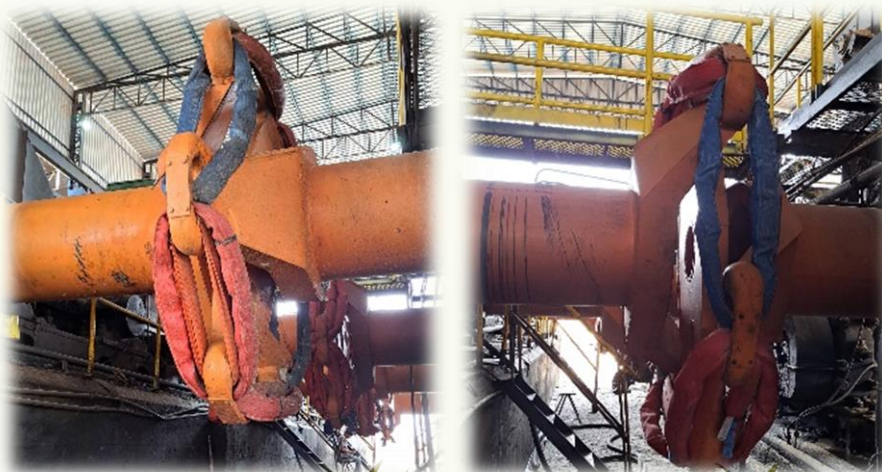
Conjunto de Acoplamentos da Moenda
